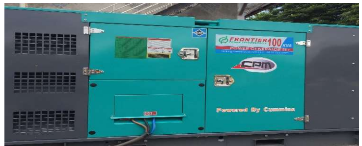
100 KVA Cummins Genset
